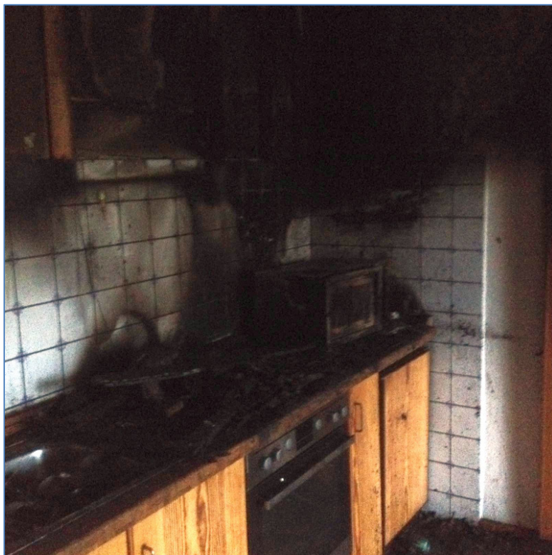
Bild 01: Die Küche wurde von den Flammen in Mitleidenschaft gezogen.
